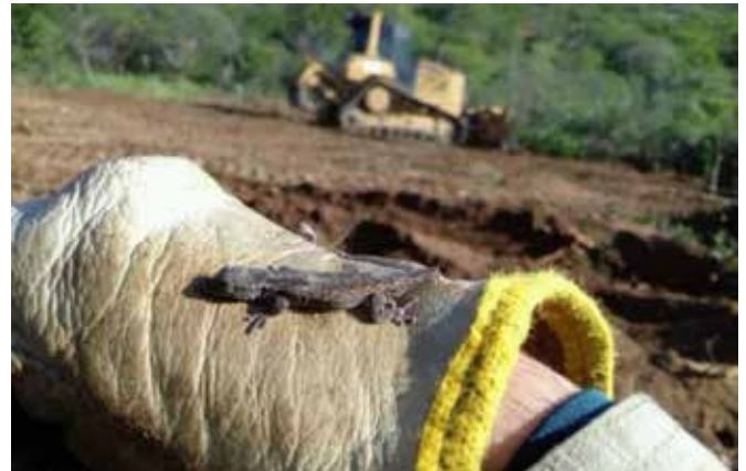
Rescate de fauna en el Complejo Eólico de Chamariz
