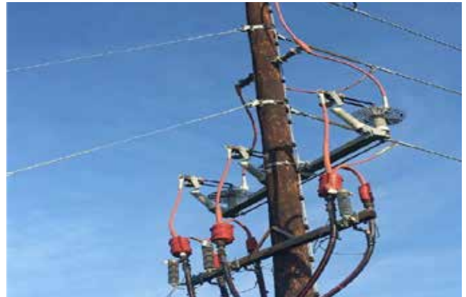
Ejemplo de un poste con cubiertas y barreras para minimizar el riesgo de electrocución de la fauna y la consiguiente interrupción del funcionamiento de la planta.
