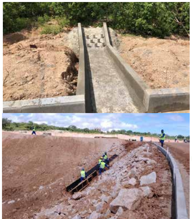
Sistema de drenaje instalado en Parques eólicos
